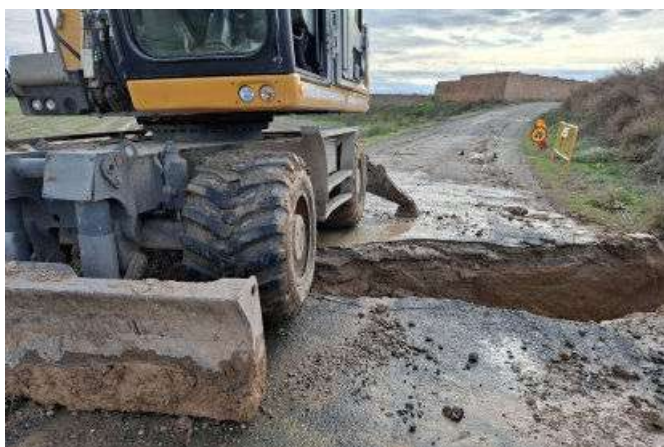
Nueva ruptura en la red de agua en el Horta de Lleida por las obras de la MAT entre Lleida y Alcarràs
