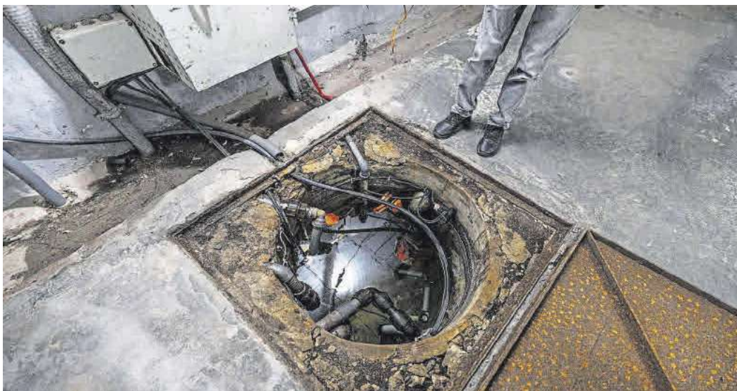
El agua que se perdía en el aparcamiento de un edificio entre la calle Canarias y González Abarca. | VICENT MARÍ
