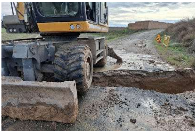
Nova ruptura a la xarxa d'aigua a l'Horta de Lleida per les obres de la MAT entre Lleida i Alcarràs
